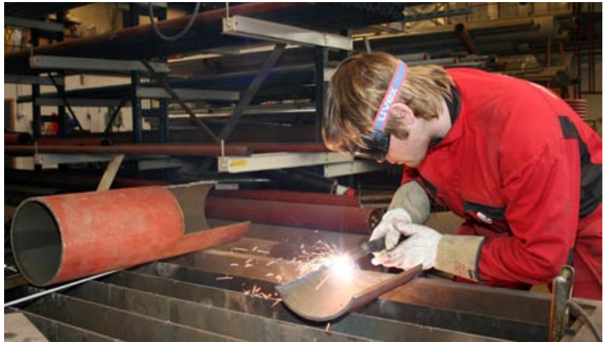
Rørleggersvenn Bent Håkon Kvernvik startet som lærling i K.Lund i for snart åtte år siden. Her sveiser han stålrør for Thamshavn Verk.
